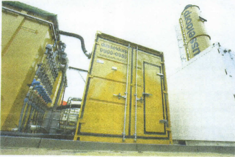
De installatie heeft een capaciteit van 50 m 3 per uur. Foto: APA/Sjef Prins
